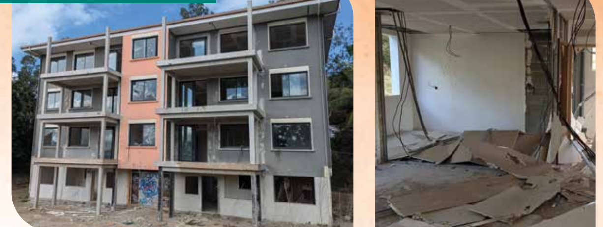
Dégradations immeuble Talon, Nouméa
